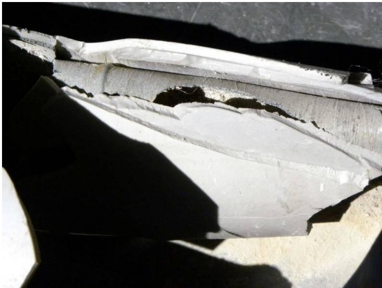
Figur 38. Exempel på en annan yttre, mer omfattande skada där även liningen har skadats. Liningen har löst sig från underlaget.
