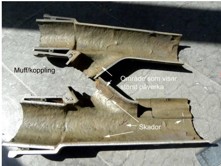
Figur 14. Översiktssbild av det uppsågade provet. Provet bestod av en rörbit som sammanfogats med ett T-stycke i en muff/koppling. Liningen uppvisade en kraftig brun missfärgning, men ytan var fortfarande glansig. Provet var mest påverkat i den nedre delen av påsticket där ytkrackelering förekom. Dessutom observerades flera stora repor eller skador i innerytan.
