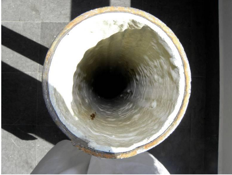
Figur 88. Invändig vy. Liningens tjocklek visade vissa variationer, de var dock jämförelsevis små. Valkar hade främst bildats i omkretsriktning. Korrosionsskadorna i gjutjärnsröret var begränsade. Vidhäftningen föreföll vara god.
