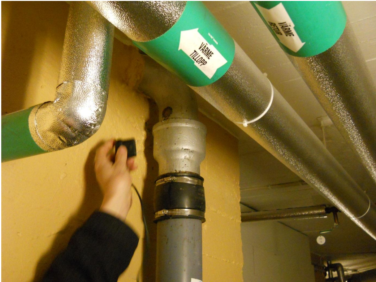
Figur 2. Stam 1 i källaren. Den mörka fläcken är platsen för skadan.
