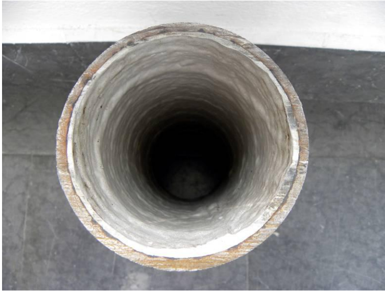
Figur 74. Invändig vy. Liningens tjocklek visade vissa variationer, de var dock jämförelsevis små. Valkar hade främst bildats i omkretsriktning. Korrosionsskadorna i gjutjärnsröret var begränsade. Vidhäftningen verkade vara bra.
