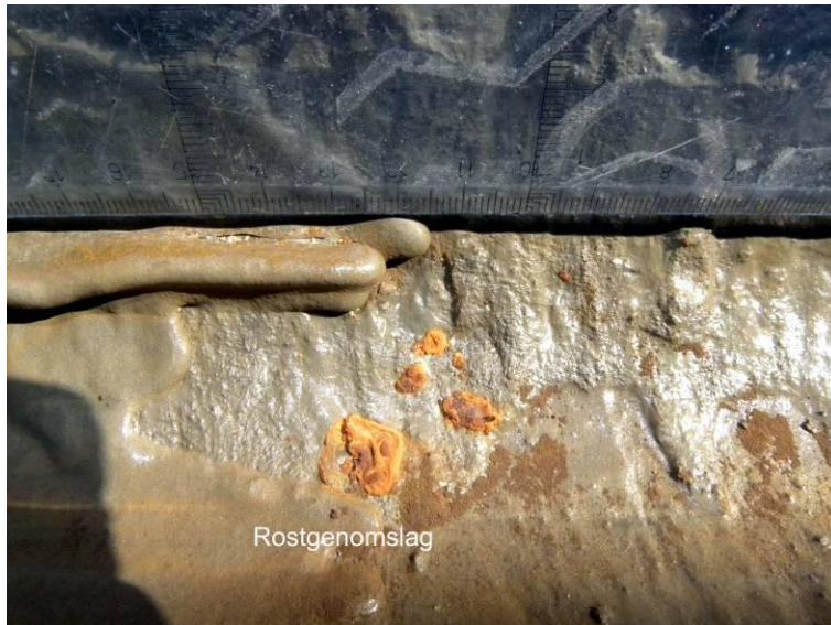
Figur 28. Bild på det andra området med rostgenomslag. Även här handlade det om ett område där korrosionsprodukter antagligen inte har avlägsnats innan röret relinades. Liningen var mycket tunn.
