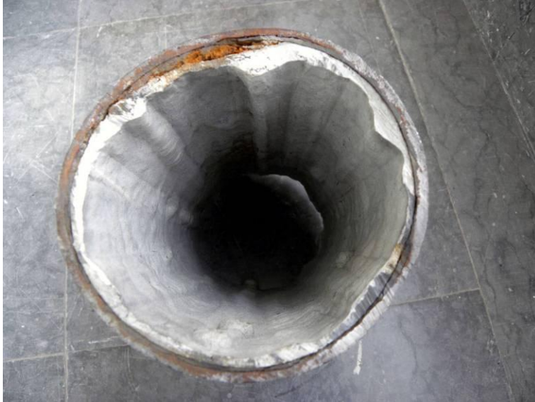
Figur 67. Invändig vy. Liningens tjocklek visade stora variationer. Axiella valkar fanns. Gjutjärnsröret uppvisade grafitering och i en del förekom lösa korrosionsprodukter. På några ställen hade liningen släppt från underlaget.
