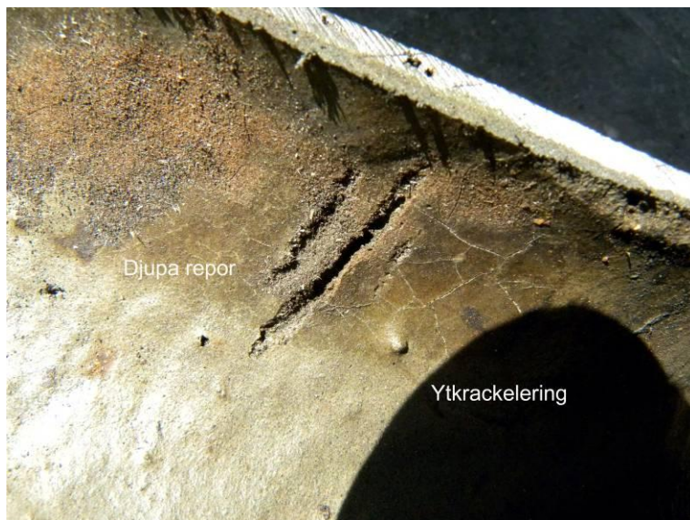
Figur 17. Närbild på ytkrackeringskadorna och de två djupa reporna. I ytsprickorna syns färskt reliningmaterial med gummikulor. Reporna var täckta med en beläggning och verkade därför vara äldre. De är djupa och en av dem var nästan genomgående till gjutjärnsröret.
