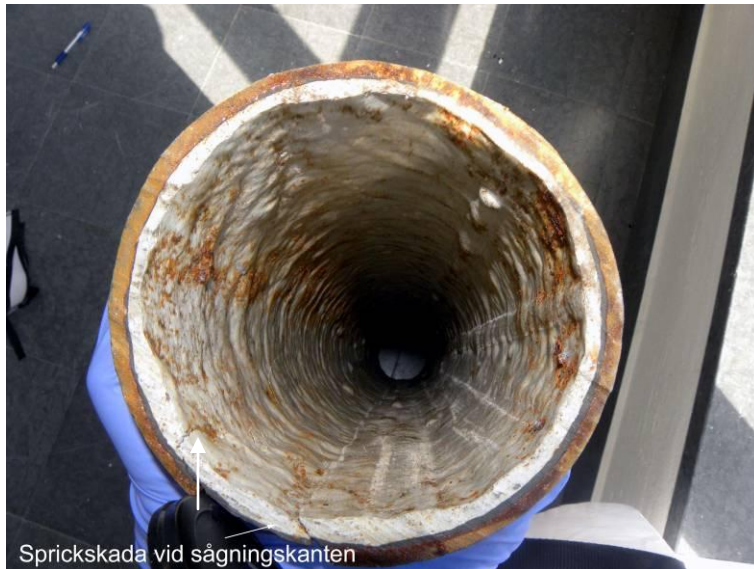
Figur 82. Invändig vy sedd från rörsidan. Det förekommer vissa tjockleksvariationer i liningen. Sprickorna som syns i sågningskanten har uppkommit i samband med provtagningen.
