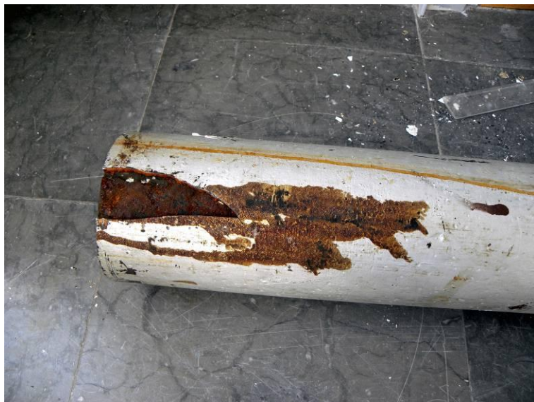
Figur 80. Röret var skadat vid ena ändan. Även liningen visade sprickbildning i detta område, tydligen härstammande från provtagningen.
