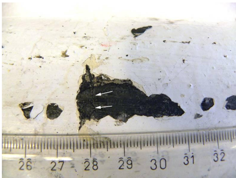
Figur 47. En sprickskada verkade finnas på rörets utsida under färgen.
