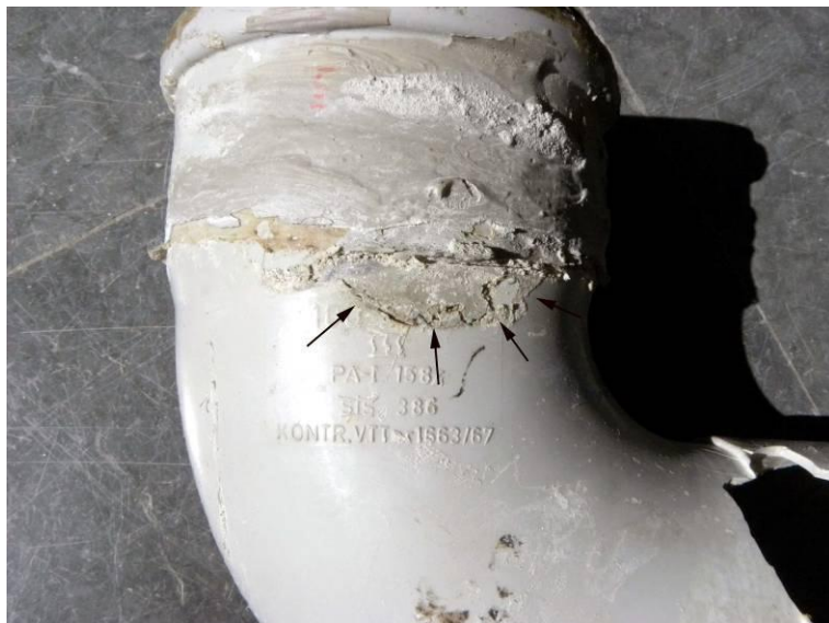
Figur 36. Yttre vy av röret som visar området där sprickorna fanns i föregående bild. Denna skada kan ha funnits före provtagningen. Det är möjligt att läckan har uppkommit här.
