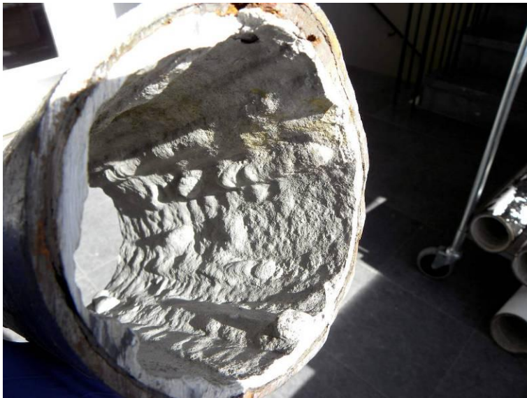
Figur 68. Annan invändig vy som tydliggör de stora tjockleksvariationerna i liningen. Man har lagt liningen med för stor tjocklek så att den kunnat börja rinna innan den härdade.
