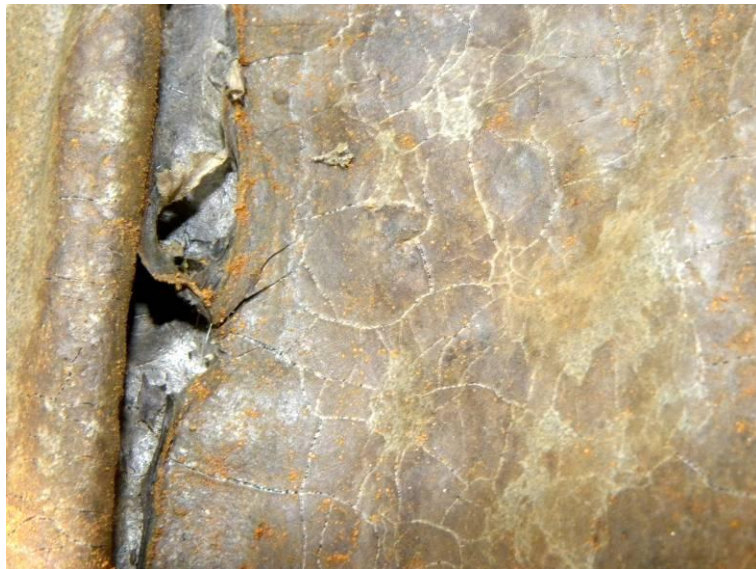
Figur 26. Närbild på ytkrackeringskadorna. I ytsprickorna syntes färskt reliningmaterial med gummikulor.
