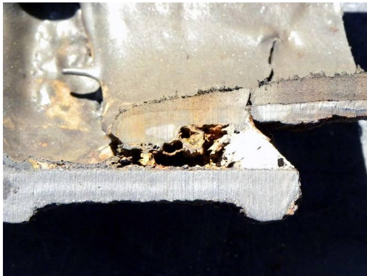
Figur 6. Tvärsnitt som visar muff- eller kopplingsövergången i större förstoring. På grund av hålrummet mellan muff och rör har liningen inte kunnat täcka spalten. Korrosionsprocesserna i gjutjärnsröret fortsatte då.
