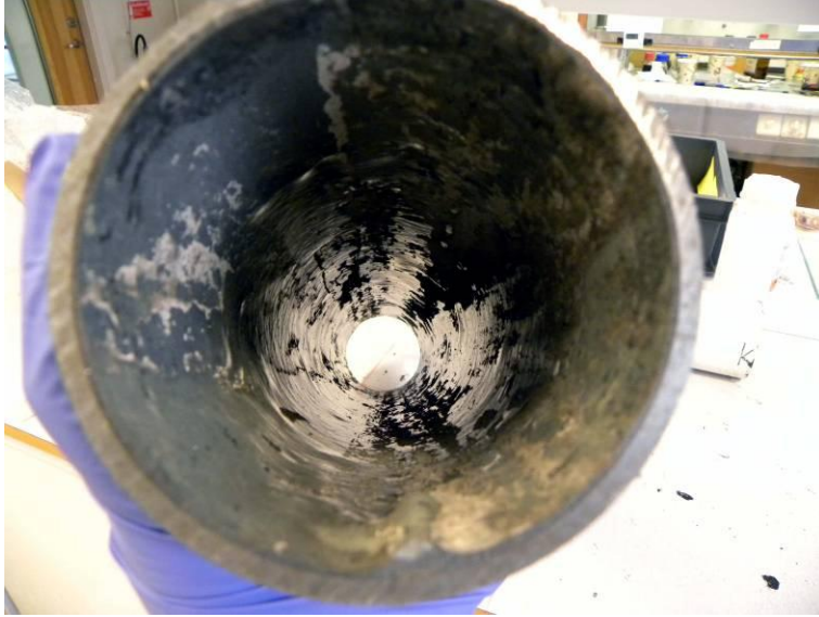
Figur 48. Invändig vy. Liningens yta var glansig. Beläggningar förekom. Liningens tjocklek var någorlunda jämnt fördelad.
