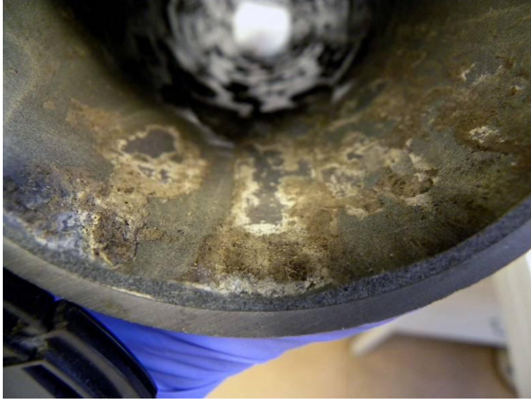
Figur 51. Viss beläggning förekom i röret. Liningen under beläggningen verkade vara i samma kondition som den friliggande liningen.
