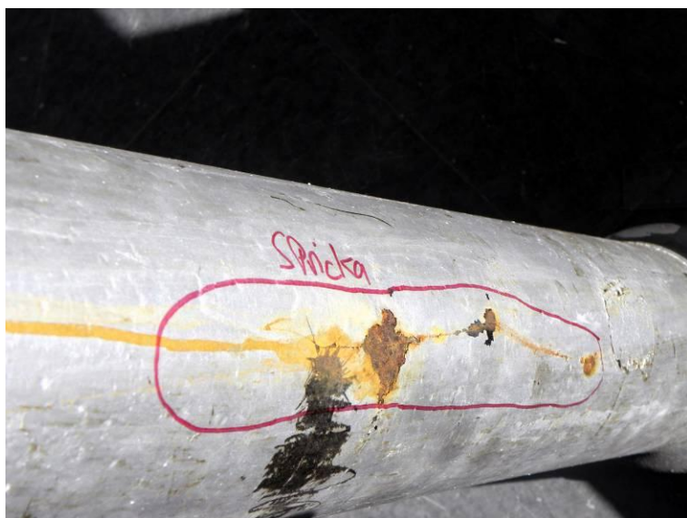
Figur 81. En annan skada fanns i rörets mitt där en axiell, cirka 30 cm lång spricka observerades som verkade vara genomgående. Inga defekter hittades i liningen i detta område vid visuell undersökning.
