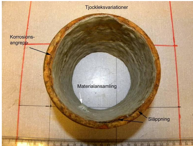
Figur 56. Invändig vy. Liningens tjocklek verkade tunn och uppvisade viss variation både i omkretsriktning och längdriktning. En materialansamling fanns i mitten av provet. Gjutjärnsröret uppvisade kraftigt korrosionsangrepp, och på flera ställen hade liningen släppt.
