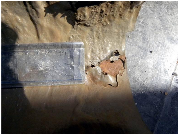
Figur 24. Exempel på ett område där linningen satt löst. Orsaken var förekomsten av korrosionsprodukter samt eventuellt påkänningar från provuttaget. Utöver det var linningen mycket tunn.
