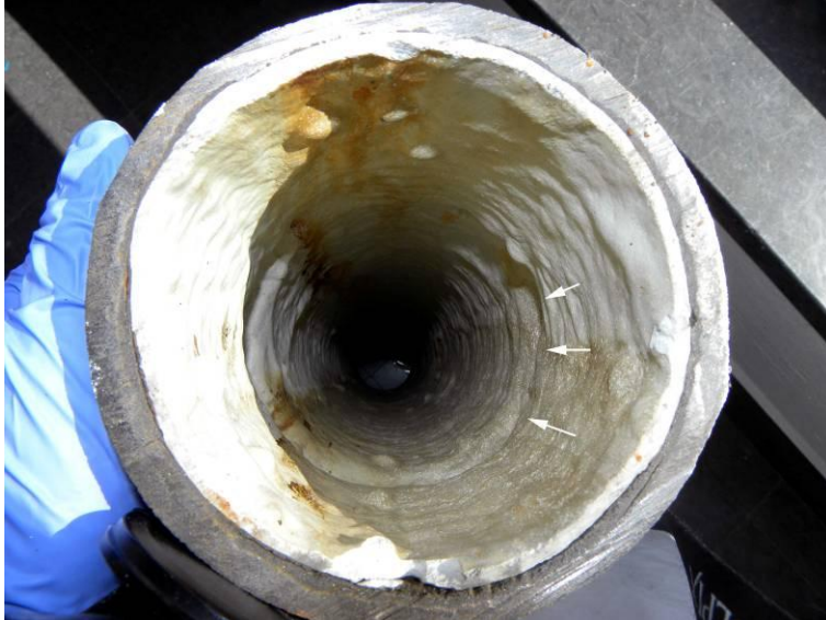
Figur 90. Invändig vy sedd från muffen/kopplingen. Liningen täcker muffövergången (som har markerats med pilar) bra.
